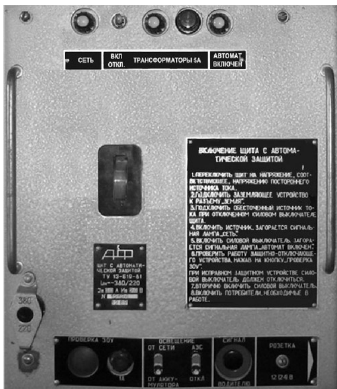
Рис. 10. Щит автоматической защиты
